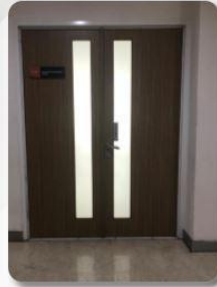
Kusen Aluminium, daun pintu multiplex rangka dengan kaca 5 mm, pada ruangan kerja dan ruangan edukasi
