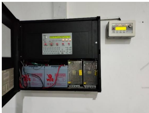
Sistem Fire Alarm Gedung IMERI
