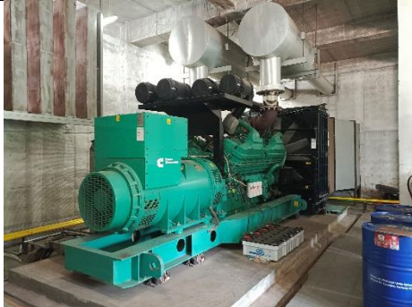
Sistem genset Gedung IMERI menggunakan ATS ( Automatic Transfer Switch )
