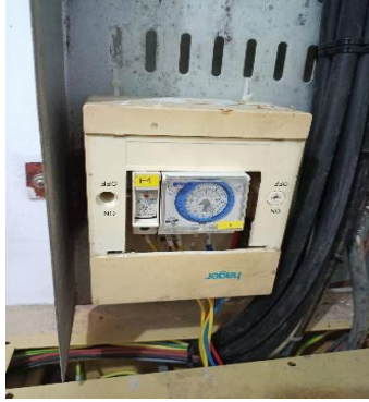
Timer Otomatis Exhaust Fan Basement Gedung IMERI
