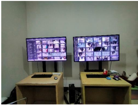
CCTV Gedung IMERI
