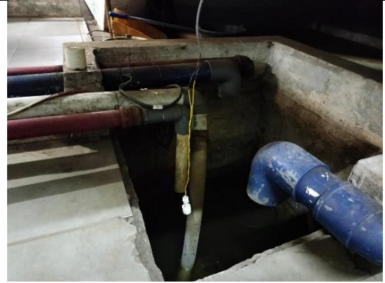
Sistem Alarm di Gedung Utilitas
