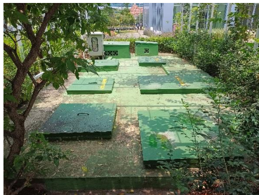
Air Bekas AC IMERI disalurkan ke STP WTP untuk Diolah Kembali
