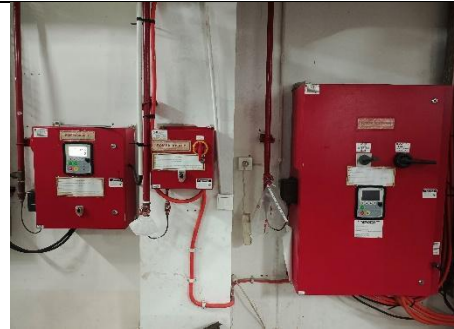
Sistem Pemadam Kebakaran Gedung IMERI
