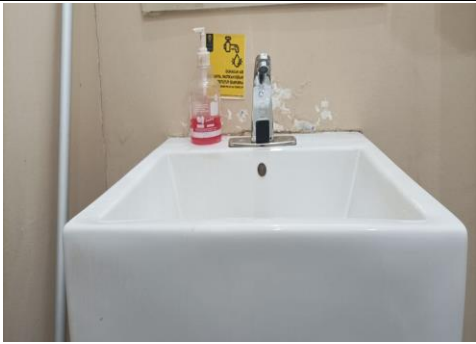
Kran Sensor Wastafel Gedung H
