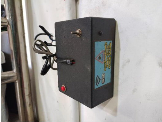
Alarm Pendeteksi Banjir di Gedung Utilitas
