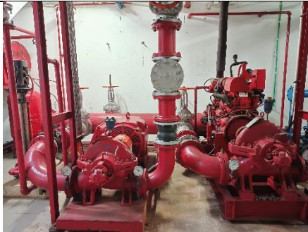
Sistem Pemadam Kebakaran Gedung IMERI
