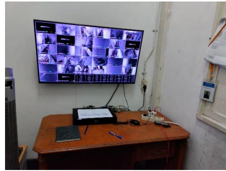
CCTV Gedung - H
