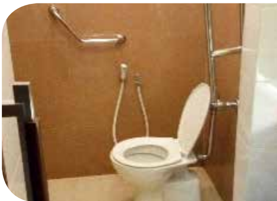
Toilet flushing system pada Toilet Difable. Toilet flushing system at the Disabled Toilet.
