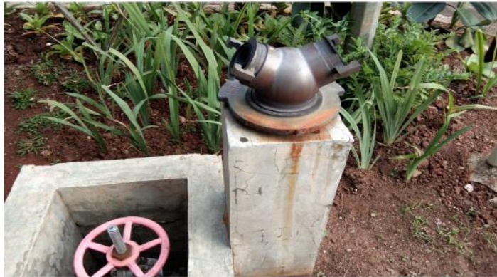
Siamese connection (Koneksi ke mobil pemadam kebakaran)
