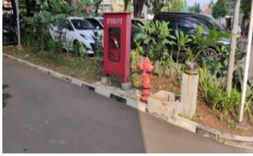
Box Hydrant di luar gedung
