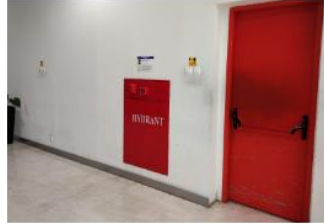
Box Hydrant di dalam gedung
