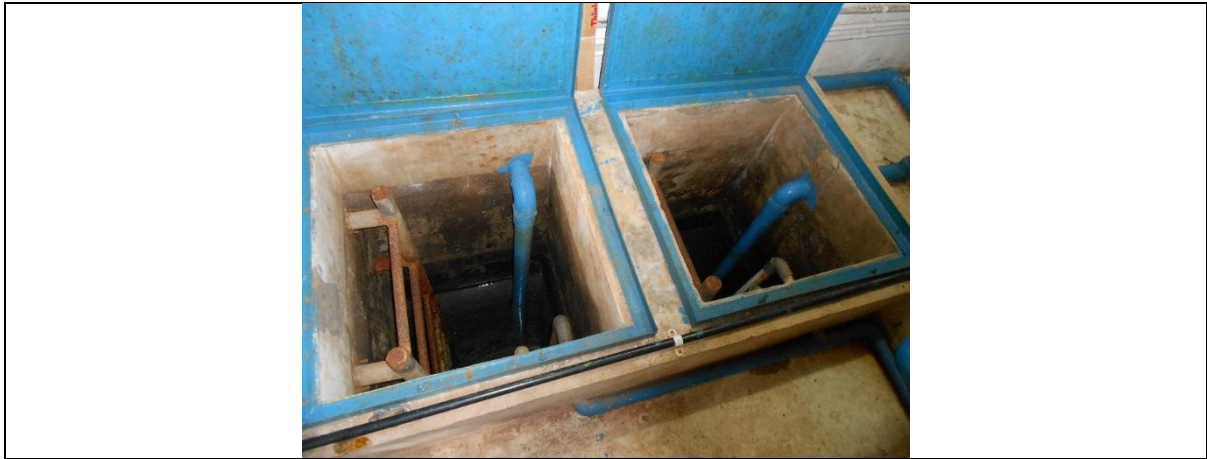
Ground Tank untuk menampung dan menyimpan air tanah
