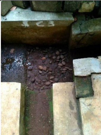
Sump Pit beton pada saluran pembuangan air hujan di Gedung DTS diubah/dialihfungsikan menjadi sumur resapan.
