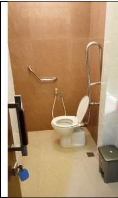
Toilet flushing system pada Toilet Difable
