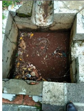
Sump Pit beton pada saluran pembuangan air hujan di Gedung K (RKB 1) yang diubah/dialihfungsikan menjadi sumur resapan.
