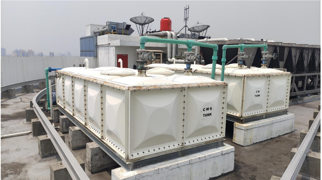
Penampungan air daur ulang yang akan didistribusikan langsung ke seluruh Gedung IMERI
