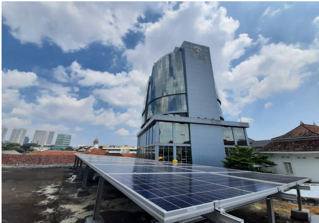
PLTS di atas Dak Gedung Utilitas
